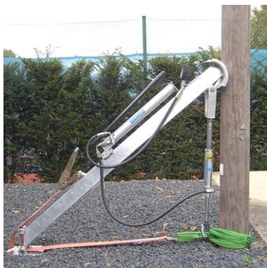
Kontroll av trästolpar utan borrhov.
